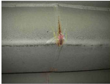
(b) Riss im Stoß der Trapezsteifen mit zusätzlicher Abplatzung des Korrosionsschutzes
